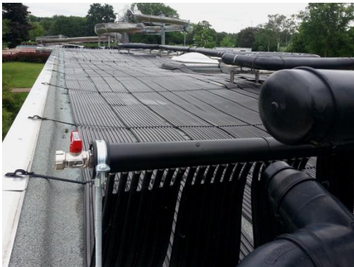
(Solarabsorber auf dem Dach)
